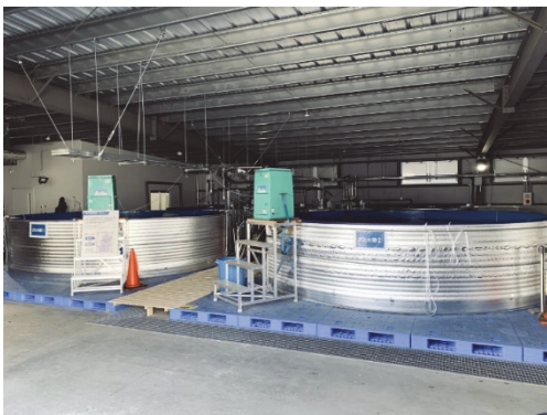
写真-6 実験棟内にある2基の20000L水槽
