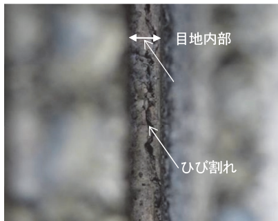
写真-8 側壁目地内のひび割れ (Case5)
