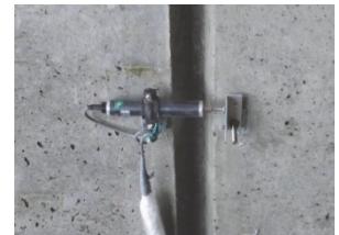
写真-2 目地部変位計
