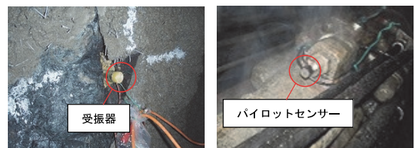
写真-1 受振器設置状況 写真-2 パイロットセンサーの設置状況
