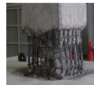
(a) 損傷状況
