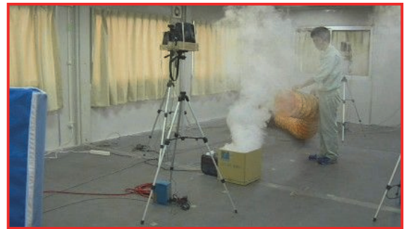
写真-8 送風機と風管による集塵
