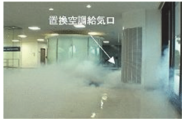
写真-2 置換空調給気口と発煙試験状況
