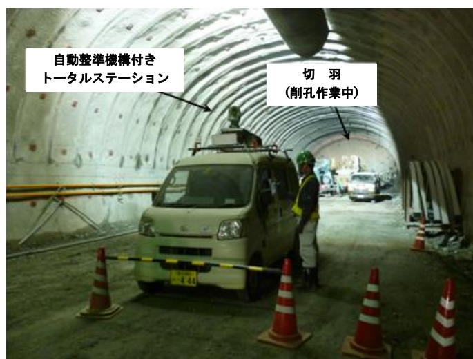
本システムによる計測状況
