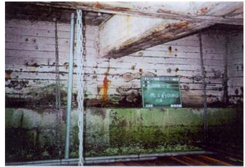
写真-1 塩害劣化による栈橋の腐食例
