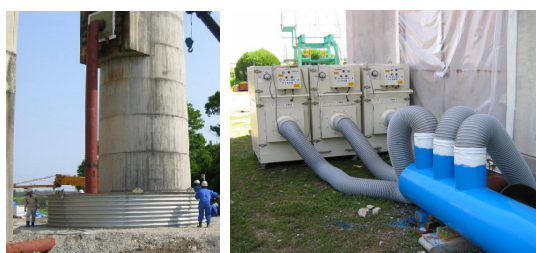
吸引配管(左)と負圧集じん機(右)
