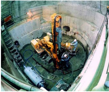
スロットスターによるスロット削孔状況 (日経コンストラクションより 撮影:玉井強志)
