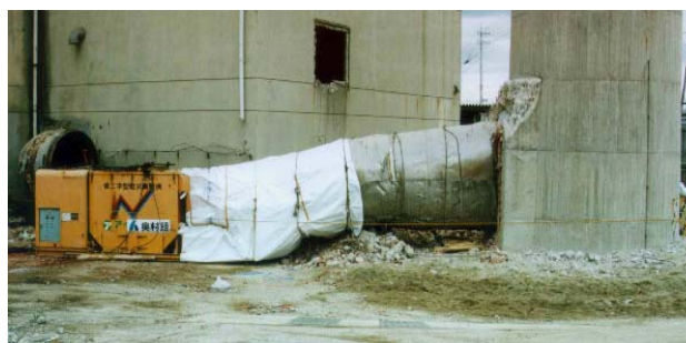
煙突下部に装備した負圧除塵機
