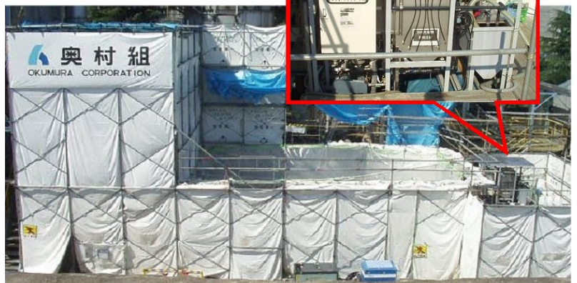
排水処理システムの実用現場
