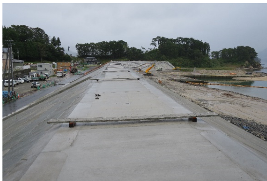
山田町織笠における防潮堤頂部間詰めコンクリートへの適用
