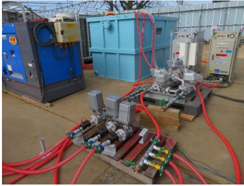
写真－3 設備配置状況
