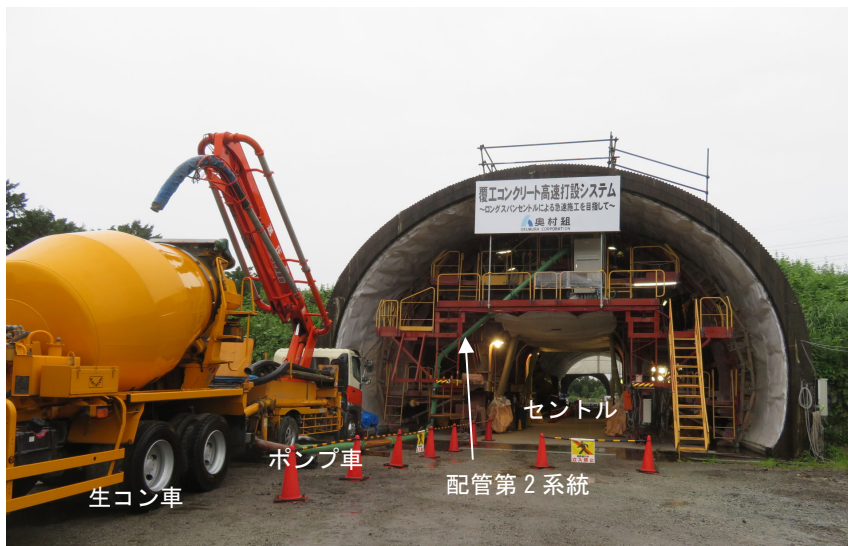
写真-2 模擬トンネルでの覆エコンクリート打設状況（後方を臨む）
