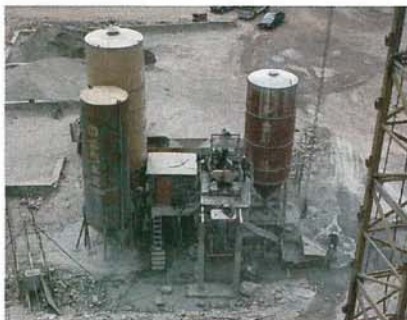
▲ SCC を製造するバッチャープラント：混和材としてフライアッシュを使用
