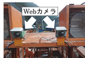
(c) Webカメラの設置状況
