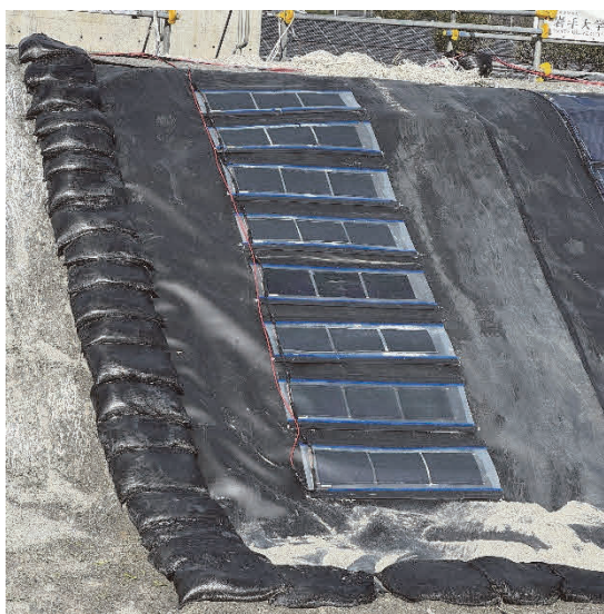
ペロブスカイト太陽電池設置状況 2)
