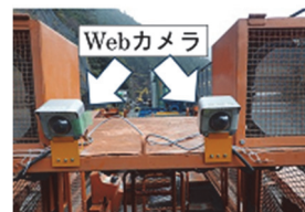
(c) Webカメラの設置状況
