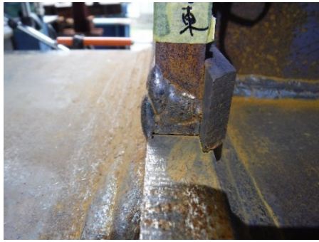
(a)+1 サイクル<鋼片部浮き> 北東溶接部
