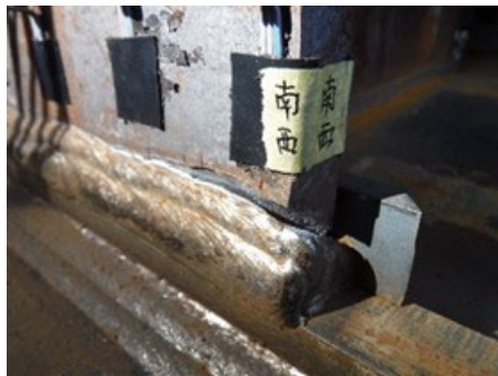
(c)－22 サイクル<耐力 10%減> 南西溶接部
