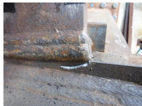
(d)+22 サイクル<幅方向亀裂 25.5mm> 南東溶接部
