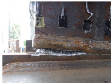
(f)+21 サイクル<幅方向亀裂 108mm> 南東溶接部
