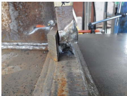
(g)+22 サイクル<破断> 南東溶接部
