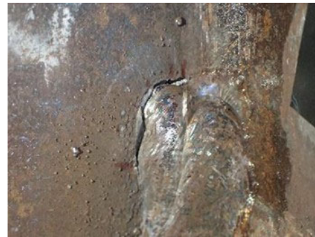
(d)－18 サイクル<フィレット部亀裂貫通> 北西フィレット部
