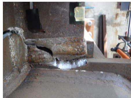
(f)+16 サイクル<破断> 南東溶接部
