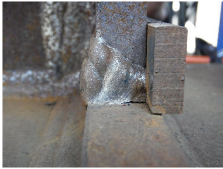
(a)+2 サイクル<亀裂発生> 南東溶接部
