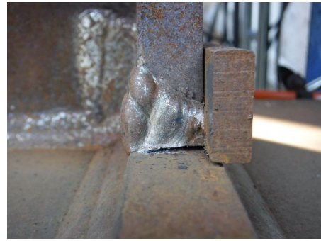
(b)+7 サイクル<板厚貫通> 南東溶接部
