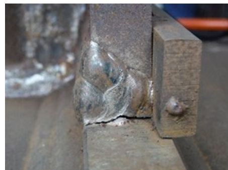
(b)+10 サイクル<板厚貫通> 南東溶接部
