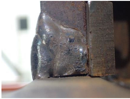
(a)+4 サイクル<亀裂発生> 北東溶接部
