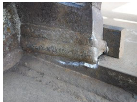
(h)+13 サイクル<破断> 南東溶接部
