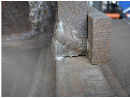
(a)+2 サイクル<亀裂発生> 南東溶接部
