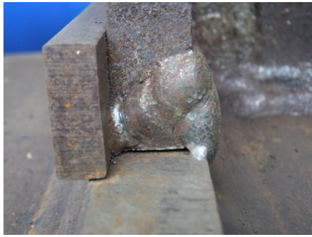
(a)－1 サイクル<鋼片部浮き> 南西溶接部
