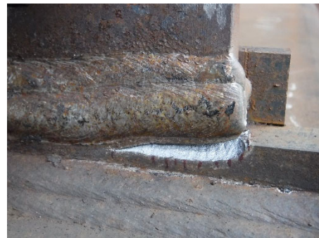
(d)+17 サイクル<耐力 10%減> 南東溶接部
