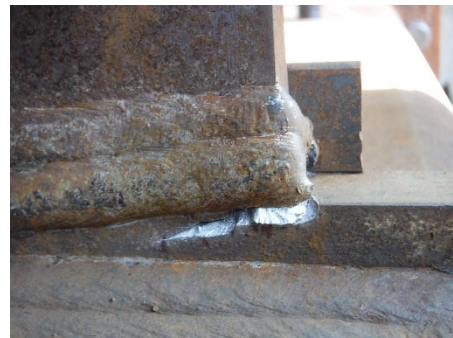
(d)+12 サイクル<幅方向亀裂 34mm> 南東溶接部
