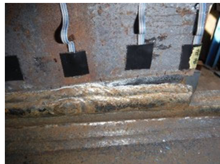
(f)－23 サイクル<幅方向亀裂 115mm> 南西溶接部
