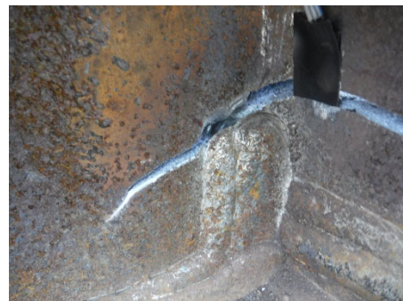
(f)+13 サイクル<破断> 南東フィレット部
