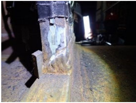
(a)－2 サイクル<亀裂発生> (東フランジ側)
