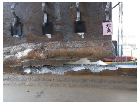
(f)+14 サイクル<幅方向亀裂 147mm> 北東溶接部
