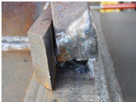
(c)+19 サイクル<耐力 10%減> 南東溶接部
