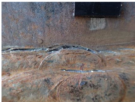
(e)+21 サイクル<※2 クレーター亀裂> 東面溶接部
