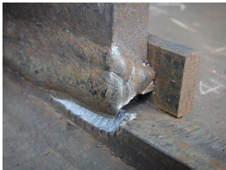
(c)+17 サイクル<耐力 10%減> 南東溶接部
