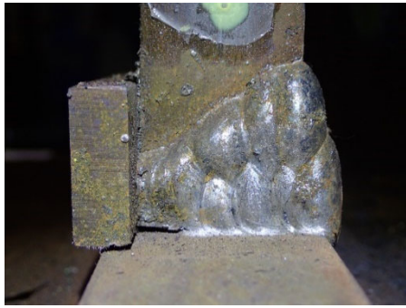
(a)+2 サイクル<亀裂発生> (東ダイアフラム側)
