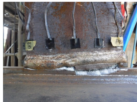
(f)-19 サイクル<幅方向亀裂 141mm> 西面溶接部
