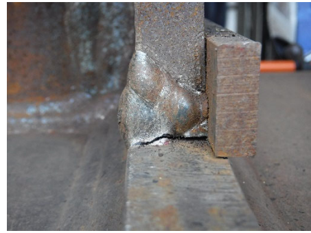
(b)+7 サイクル<板厚貫通> 南東溶接部
