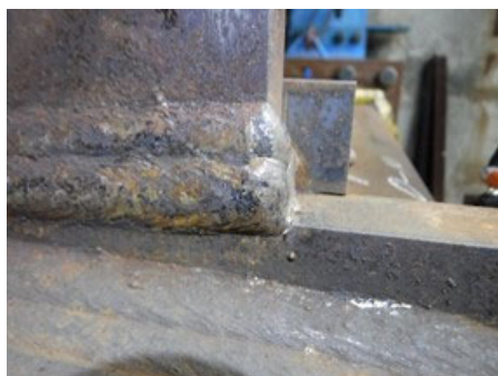
(c)+11 サイクル<D 側幅方向に進展> 南東溶接部
