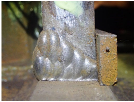
(a)+7 サイクル<亀裂発生> (東フランジ側)
