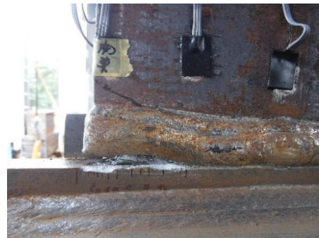
(d)-●サイクル<耐力 10%減> 南東溶接部
