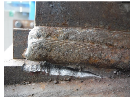
(d)－11 サイクル<耐力 10%減> 南西溶接部
