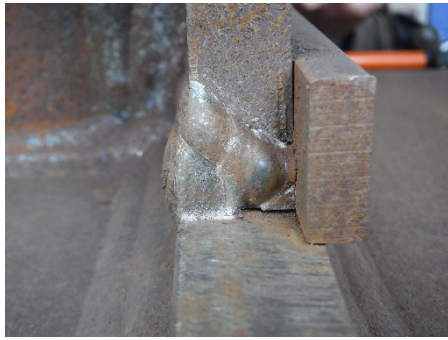
(a)+2 サイクル<亀裂発生> 南東溶接部
