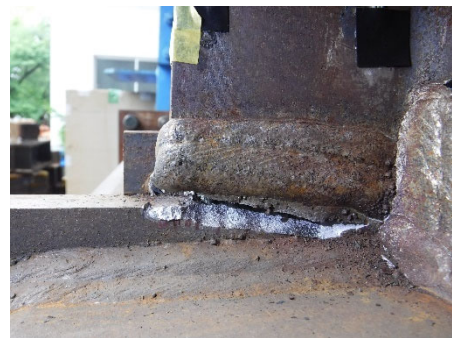
(f)－12 サイクル<幅方向亀裂 83mm> 南西溶接部
