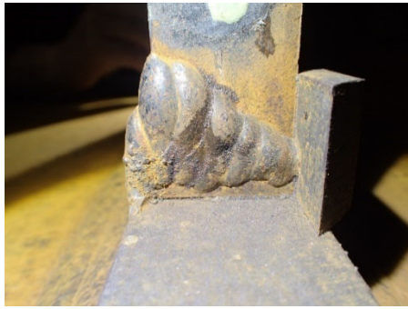
(a)+1 サイクル<鋼片部浮き> (東ダイアフラム側)
