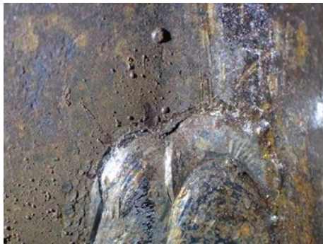
(c)－13 サイクル<フィレット部亀裂> 北西フィレット部
