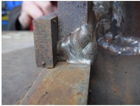
(a)－3 サイクル<亀裂発生> 南西溶接部
