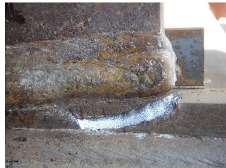
(d)+15 サイクル<幅方向亀裂 42mm> 南東溶接部
