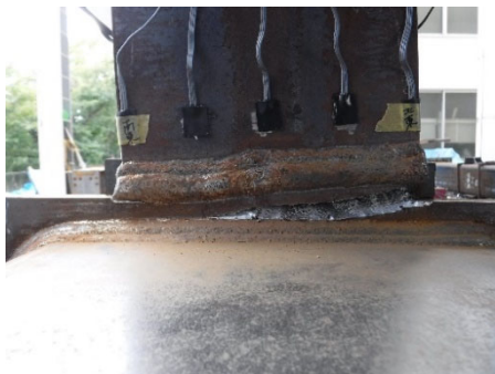
(e)+19 サイクル<幅方向亀裂 148mm> 東面溶接部
