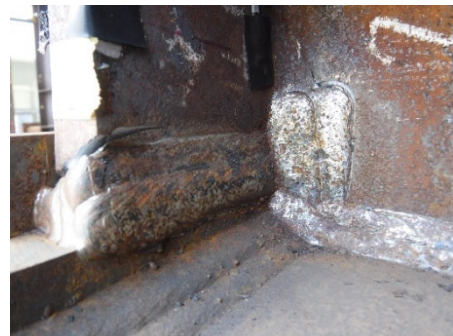
(f)－19 サイクル<幅方向亀裂 25mm> 南西溶接部
