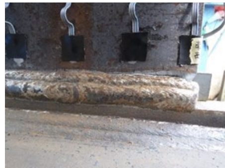
(d)－22 サイクル<耐力 10%減> 南西溶接部
