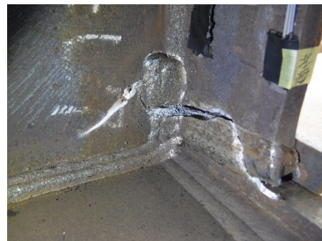
(h)－13 サイクル<破断> 北西溶接部
