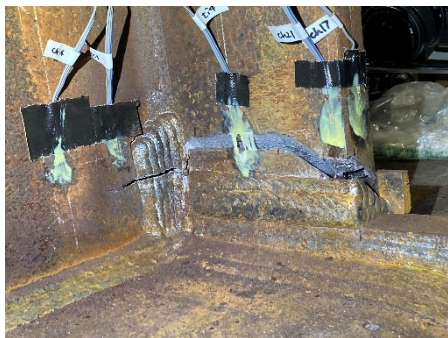
(e)+21 サイクル<破断> (東フランジ側)
