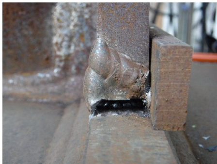
(c)+12 サイクル<破断前のピーク> 南東溶接部
