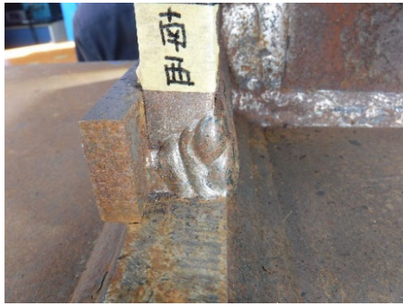
(a)－5 サイクル<亀裂発生> 南西溶接部
