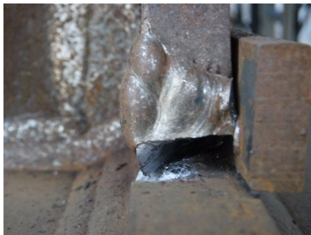
(c)+15 サイクル<破断前のピーク> 南東溶接部
