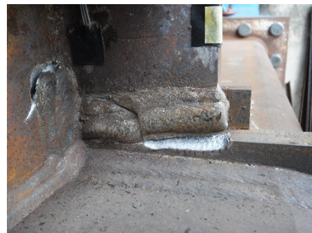
(f)+18 サイクル<幅方向亀裂 85mm> 南東溶接部
