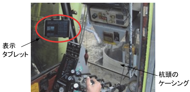
写真-2 オペレータ室の機器設置状況
