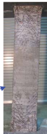
写真-1 最終破壊状況 (鋼繊維補強 RC 柱)
