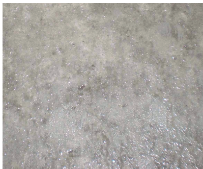
写真-3 コンクリート表面の結露 (相対湿度 85%以上)
