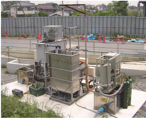
写真-2 実用機設置状況 (Ab トンネル)
