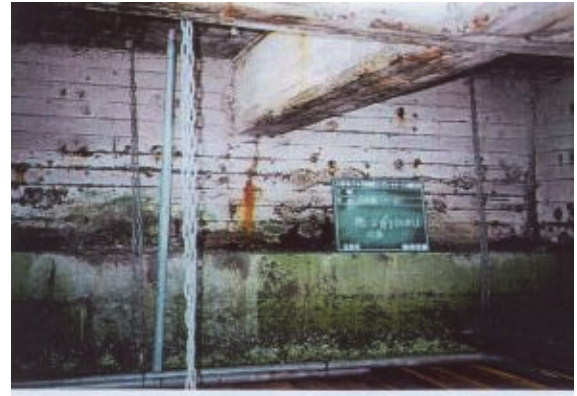
写真-1 塩害劣化による橋の腐食
