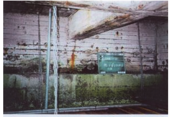
写真-1 塩害劣化による橋の腐食
