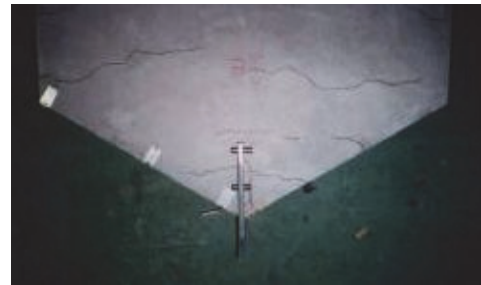
写真-4 継手部の破壊状況
