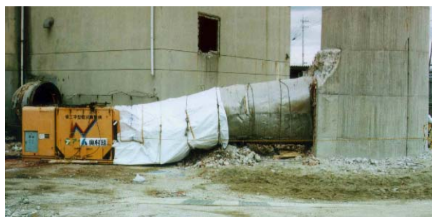
煙突下部に装備した負圧除塵機
