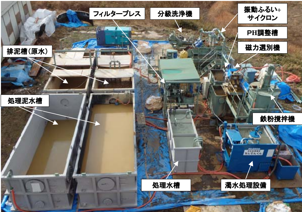
実証実験プラント全景
