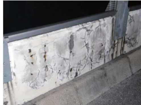
防護柵の劣化状況
