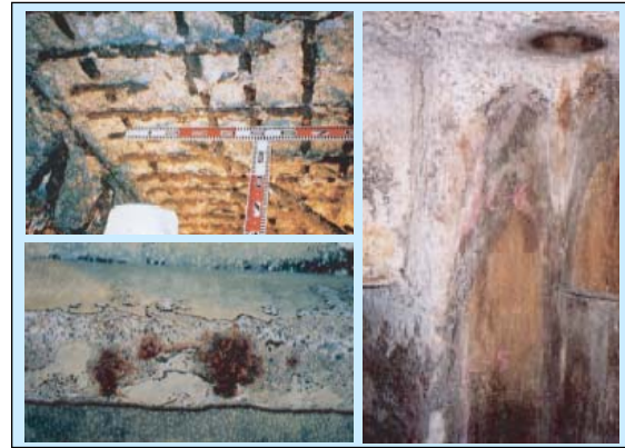
写真-1 下水道施設の腐食劣化事例
