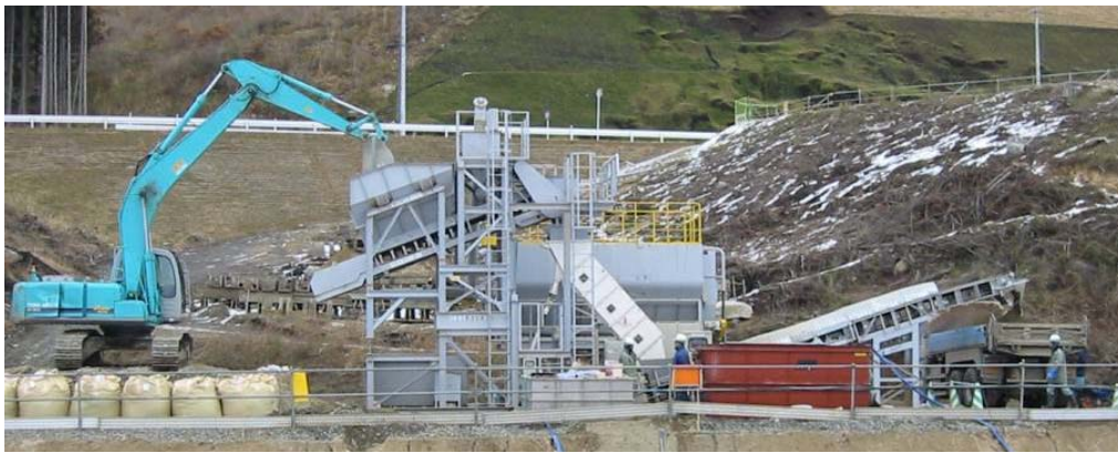
写真-3 混合設備
