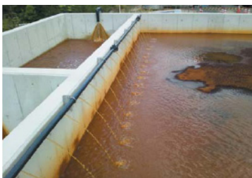
天日乾燥床への散水状況
