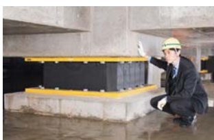
免震装置(積層ゴム)
