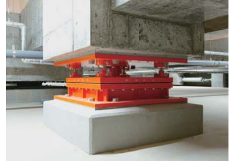
▲微振動対策ダンパー (WSD-3. 2-100:2基設置)
