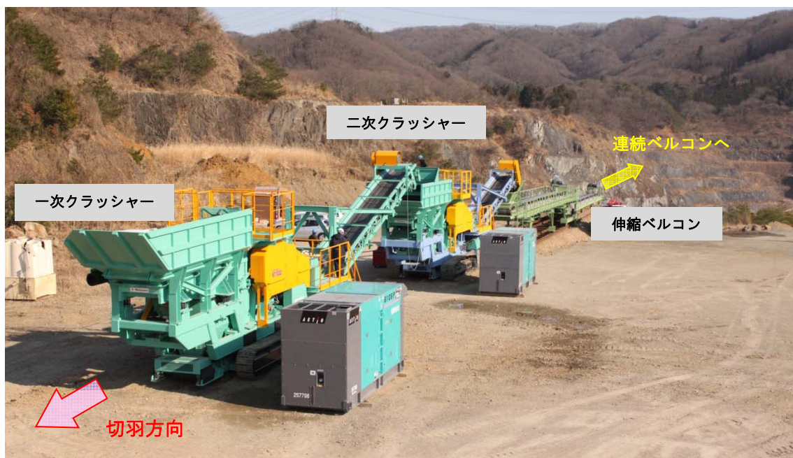
写真 1 高速ずり処理システムにおける機械設備の構成
