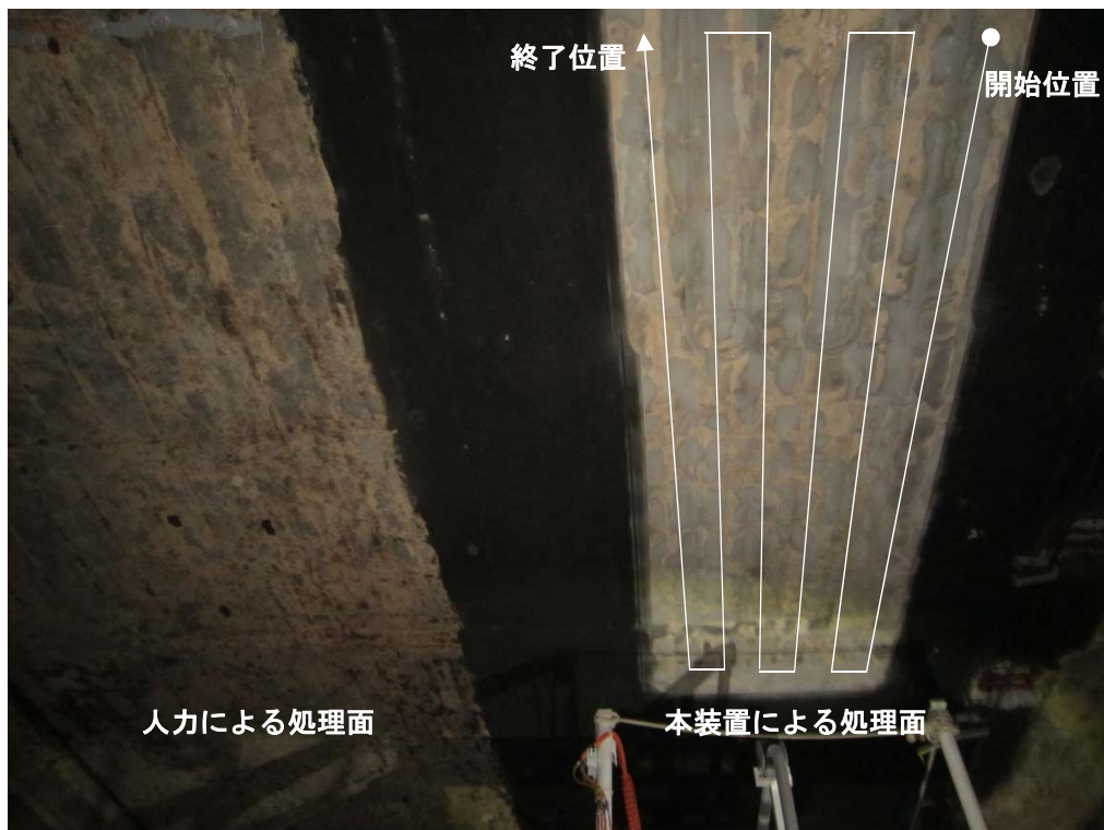
写真-4 表面処理面の比較とケレン機の1サイクルの軌跡 (左：人力施工 右：本装置による施工)
