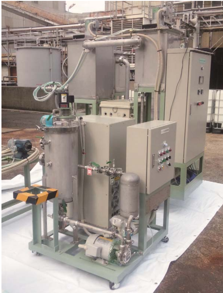
写真-1 浄化装置（全景）
