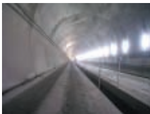
東北新幹線八甲田トンネル
