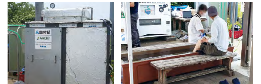
地元の竹材を使ったバイオマス発電設備による足湯
