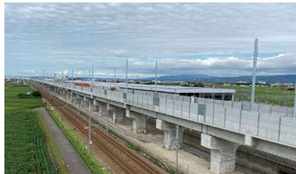
鉄道:北陸新幹線、白山宮保高架橋(石川県白山市)
