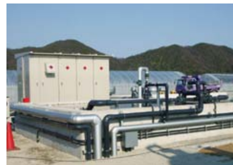
天日乾燥床、処理水貯留槽全景
